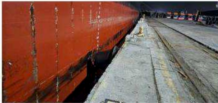
Afectación a las defensas del muelle no. 3 de compas
