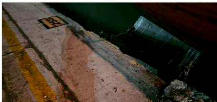
Desprendimiento de defensa muelle No. 3
