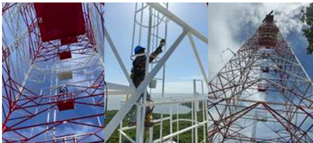
Figura 22. Mantenimiento torres auto soportadas
